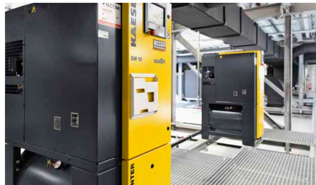
Δύο AIRCENTER εγκατεστημένα στο νέο κέντρο logistics.
